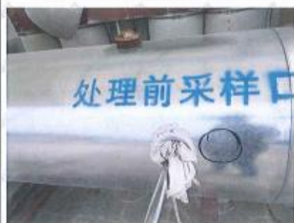
C 栋 DA001 废气处理前 3#检测口
