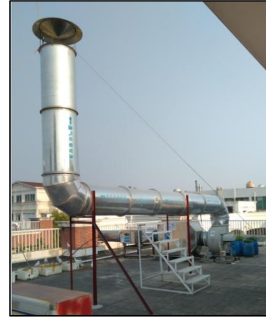
B 栋楼顶废气处理设施
