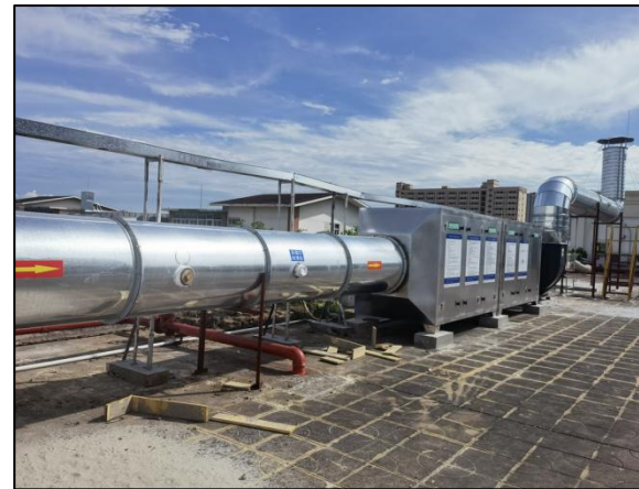
IE 栋楼顶废气处理设施
