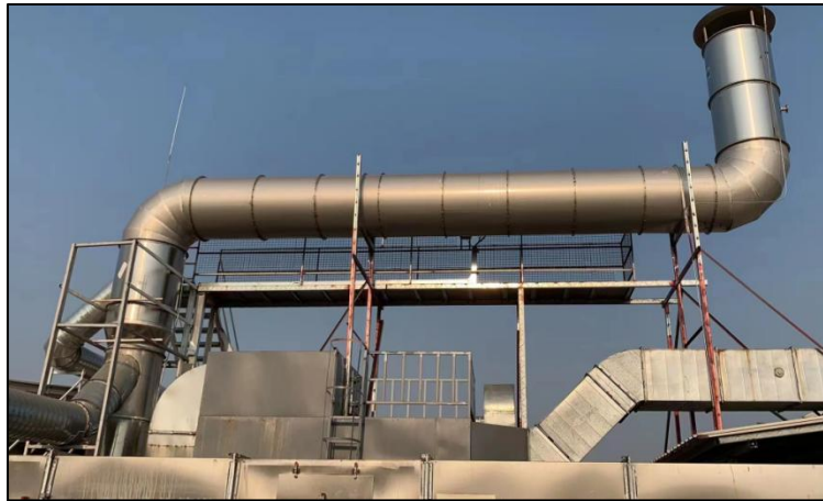
C 栋楼顶废气处理设施
