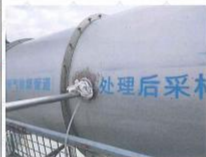
C 栋 DA001 废气处理后检测口
