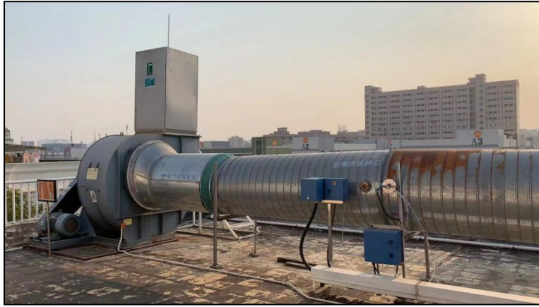
A 栋楼顶废气处理设施
