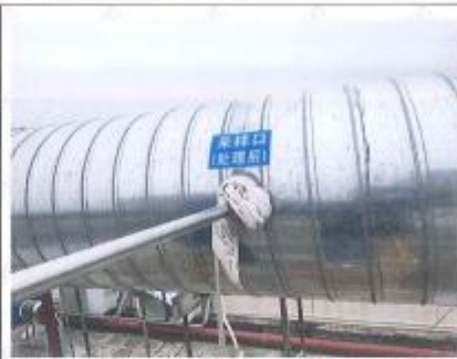
IE 栋 DA004 废气处理后检测口
