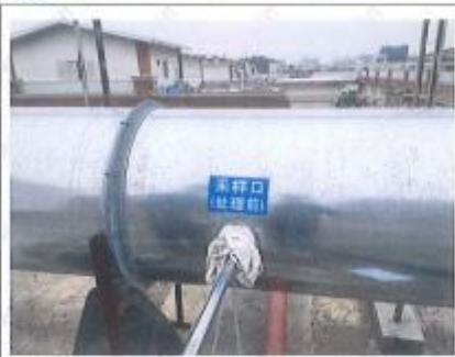
IE 栋 DA004 废气处理前检测口
