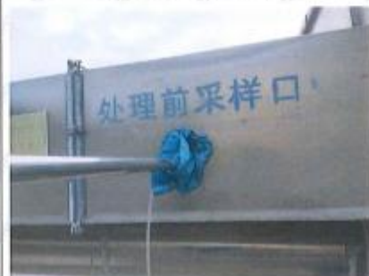
C 栋 DA001 废气处理前 2#检测口
