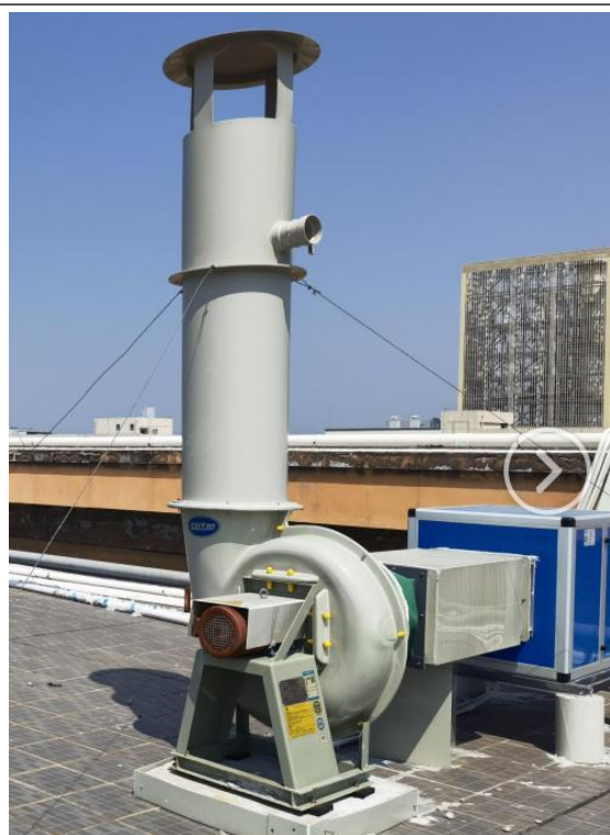
3#废气处理设施
