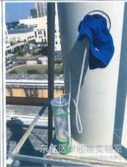
DA002 实验室废气处理后检测口
