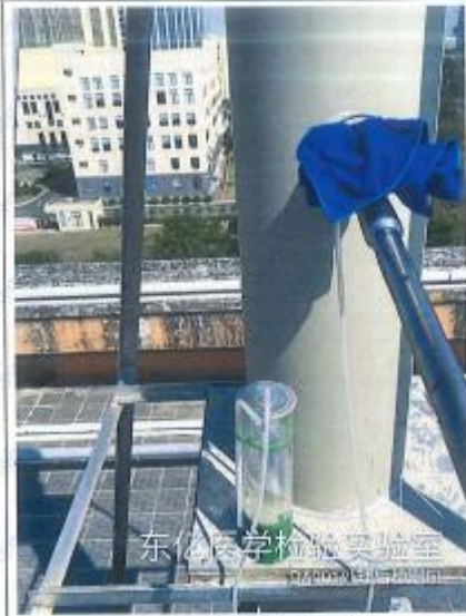
DA001 实验室废气处理后检测口
