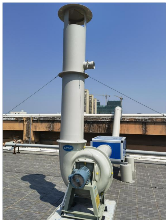
1#废气处理设施
