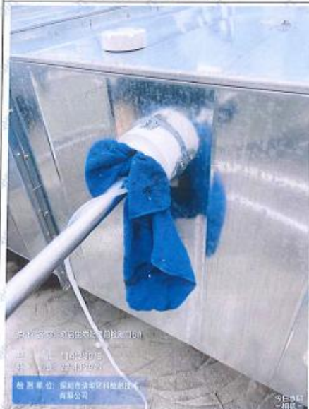
6#废气处理前检测口
