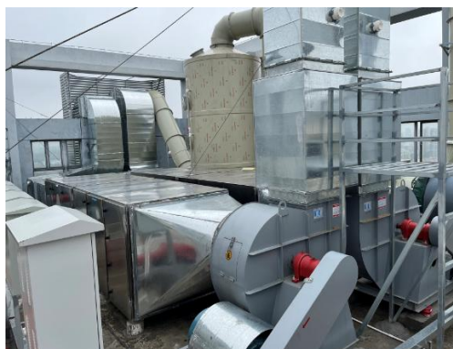
楼顶废气处理设施
