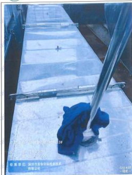
3#废气处理前检测口
