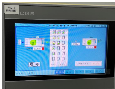
实验室排风系统
