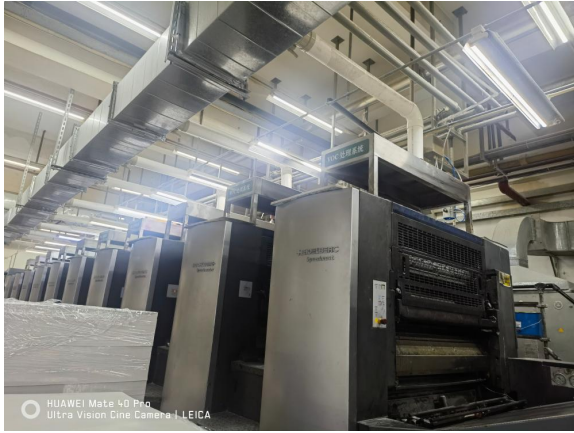
1楼印刷工位及印刷废气收集装置
