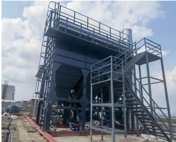
楼顶废气处理设施及排放口
